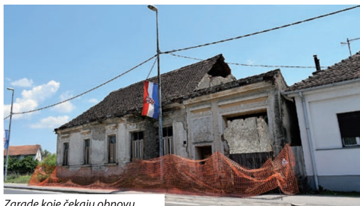
Zgrade koje čekaju obnovu
